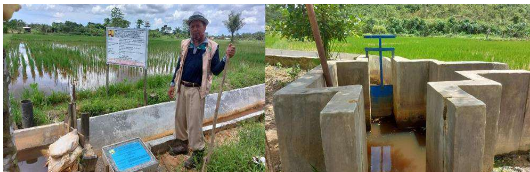
Gambar 3 Saluran irigasi pada lahan pertanian. Gambar 4 Pintu irigasi untuk mengatur debit air
